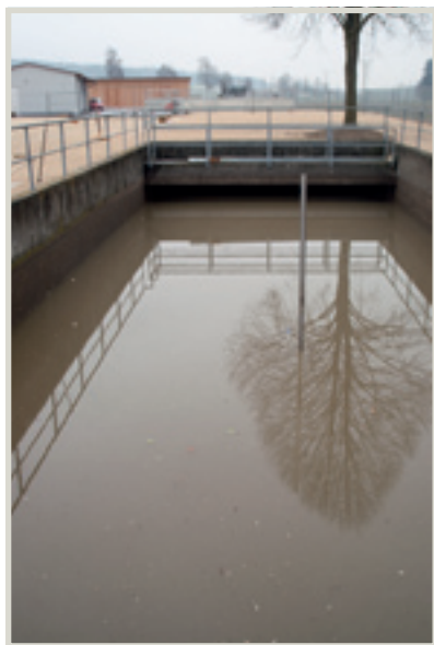
Nach Starkregen gefülltes RÜB auf der KA Gerolsbach
