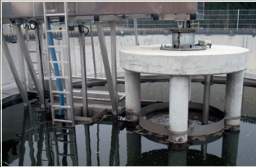
Die Kläranlage Gerolsbach ist ausgelegt für 4.000 EW
