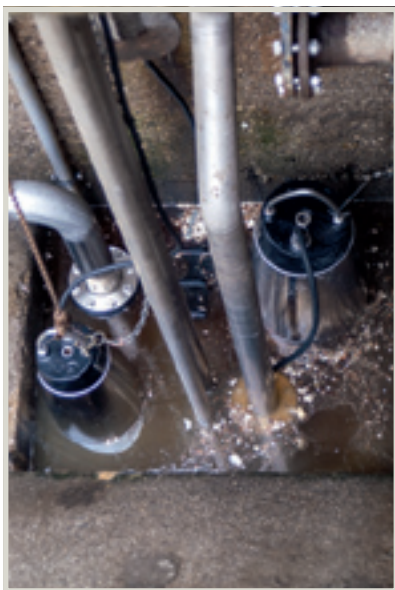
SE1 Abwasserpumpe für RainJet (links im Bild) sowie eine SEV für die Beckenentleerung
