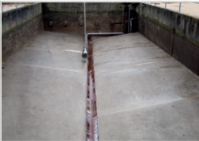
RÜB mit 210 m 3 Volumen. Der RainJet ist mittig installiert. Pumpensumpf im Hintergrund rechts.
